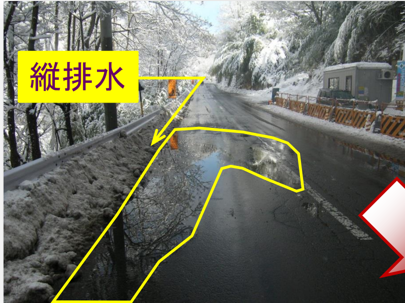
< 2. 路面排水不良 >
